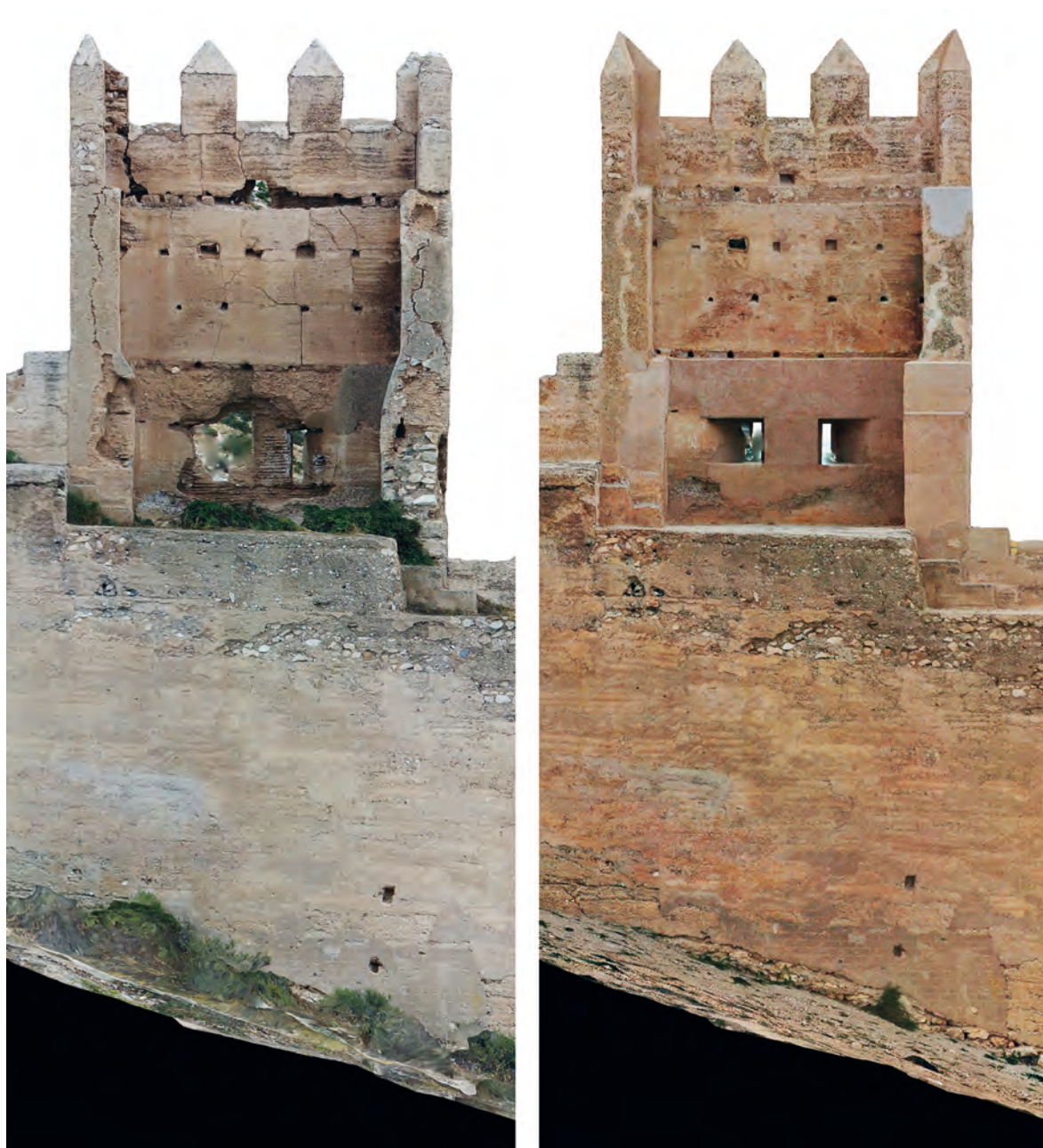
Figura 5. Ortofotografía del alzado interior de torre C6 antes y después de la intervención.
