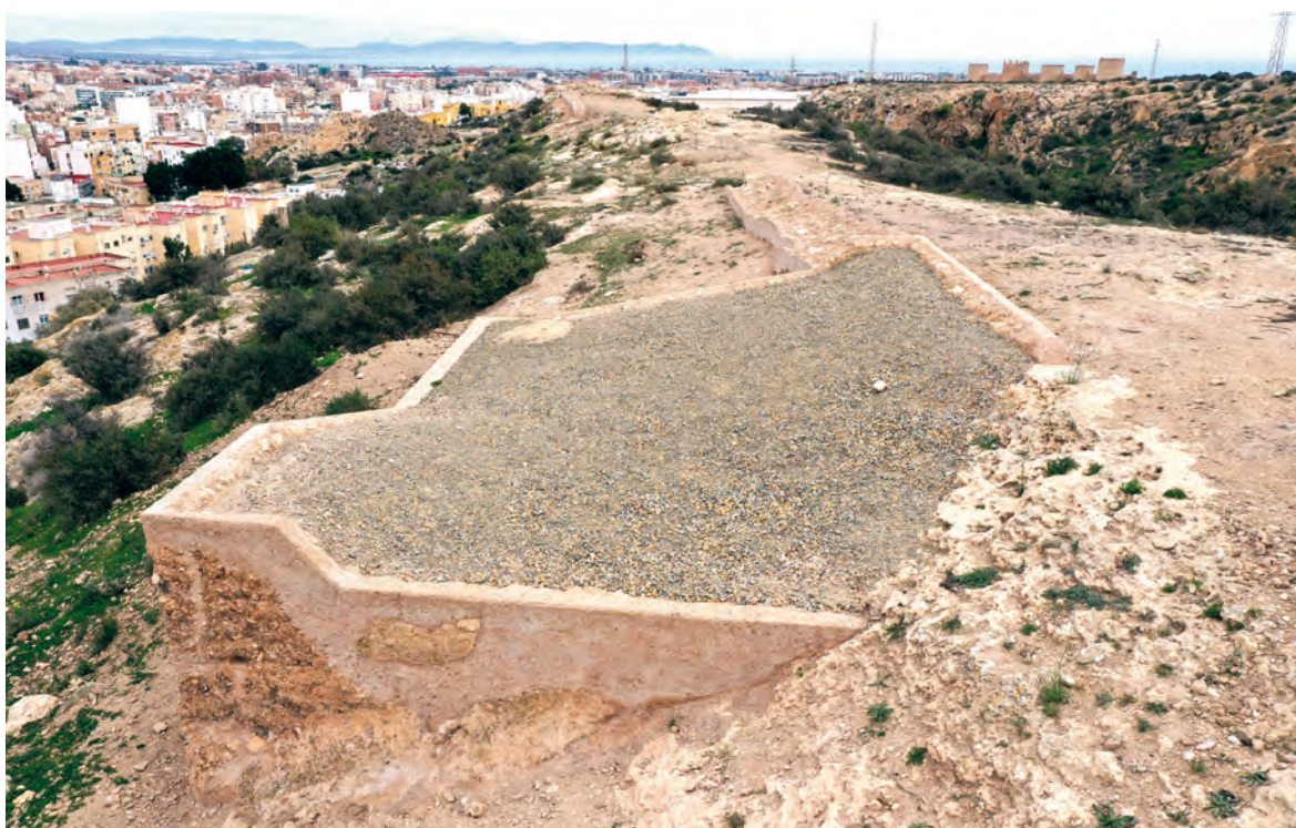
Figura 7. Vista de la torre A6 y parte del lienzo A5-A6 tras la restauración (16-02-2024).
