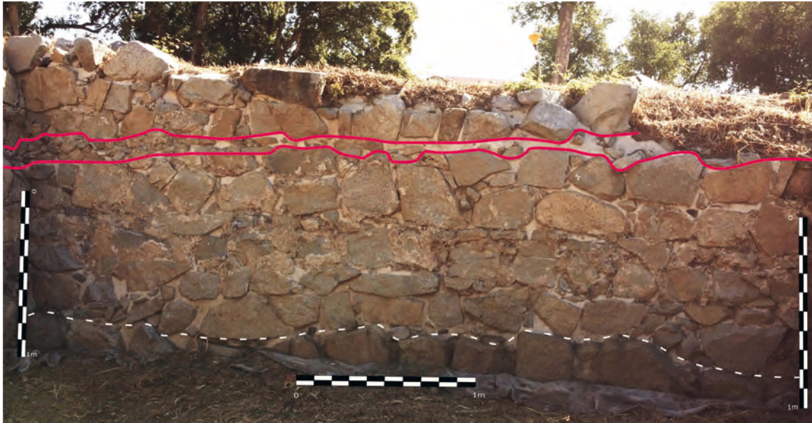
Figura 5. Detalle de la cara externa norte del tramo oeste de la muralla del recinto A.
