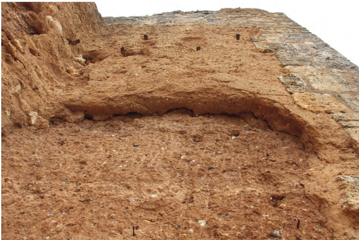
Figura 4. Estado de deterioro de las tapias de restauración de Guarner sobre la tapia original. Se aprecia la desconexión entre las tapias, la oxidación de los conectores metálicos, la disgregación de las tapias de restauración y la diferente métrica de cajones y agujales
